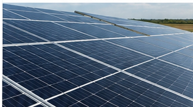
Impianto fotovoltaico - immagine illustrativa
